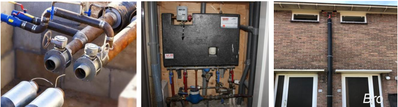
Afbeelding 21 – MT-warmtenet aansluiting in woning (links koppeling met woning, midden afleverset in meterkast, rechts warmteleidingen naar technische ruimte op zolder van de woning)
