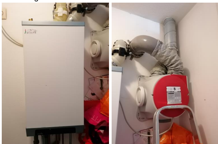
Afbeelding 12 - Individuele cv-ketel en mechanische ventilatie woningtype 4
